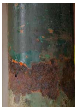
Фиг. 1 Изтъняване на основата на стълб за улично осветление, вследствие на корозия
